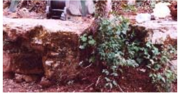
Strates manquantes en surface
