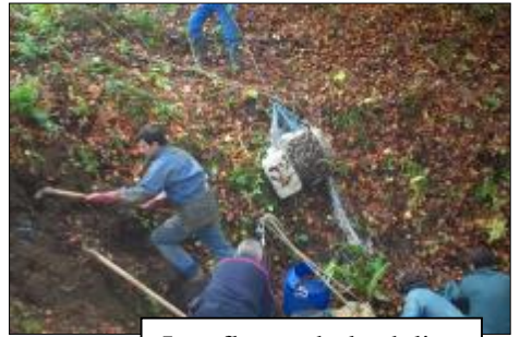
Les flancs de la doline sont raclés afin de pouvoir extraire les déchets qui se sont tassés depuis des années.
